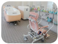
設置された「座位入浴、対面式特殊浴槽」
